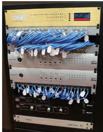
コントロールルーム内に設置した DAD AX-32
